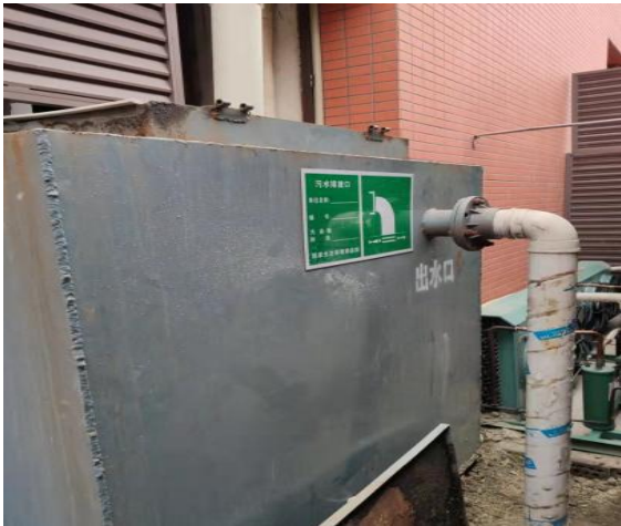
自建综合废水处理系统
