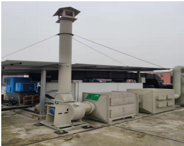
二级活性炭吸附装置+15m 排气筒
